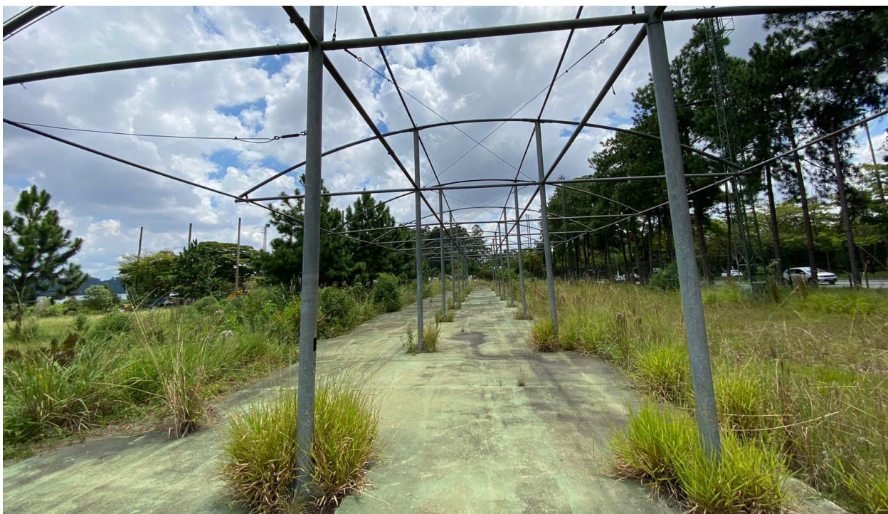
Figura 35 - Foto da estrutura metálica sem uso no terreno do futuro PARQUE PRAIA SÃO PAULO - NÚCLEO ATLÂNTICA
