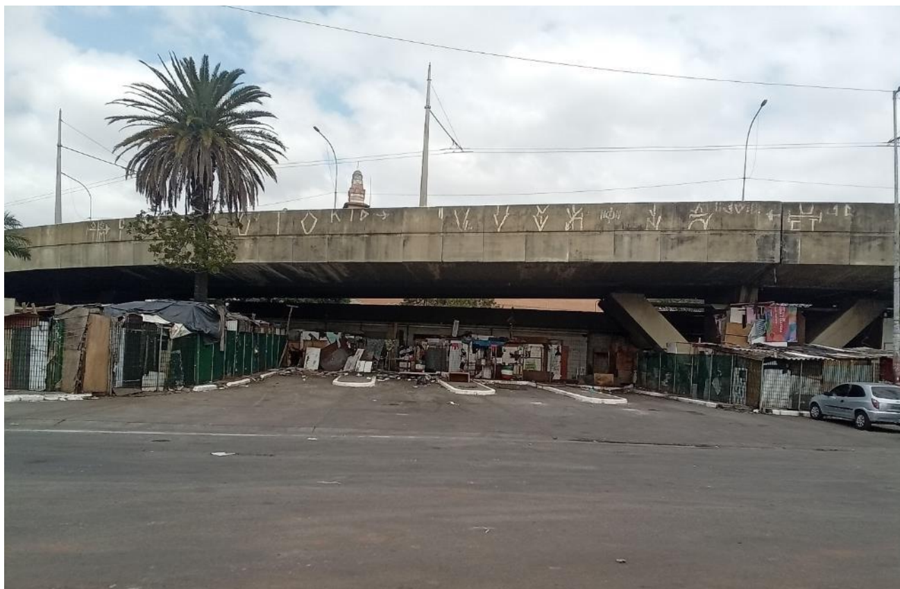
Figura 28 - Ocupação irregular no baixo do Viaduto Diário Popular junto à Praça São Vito
