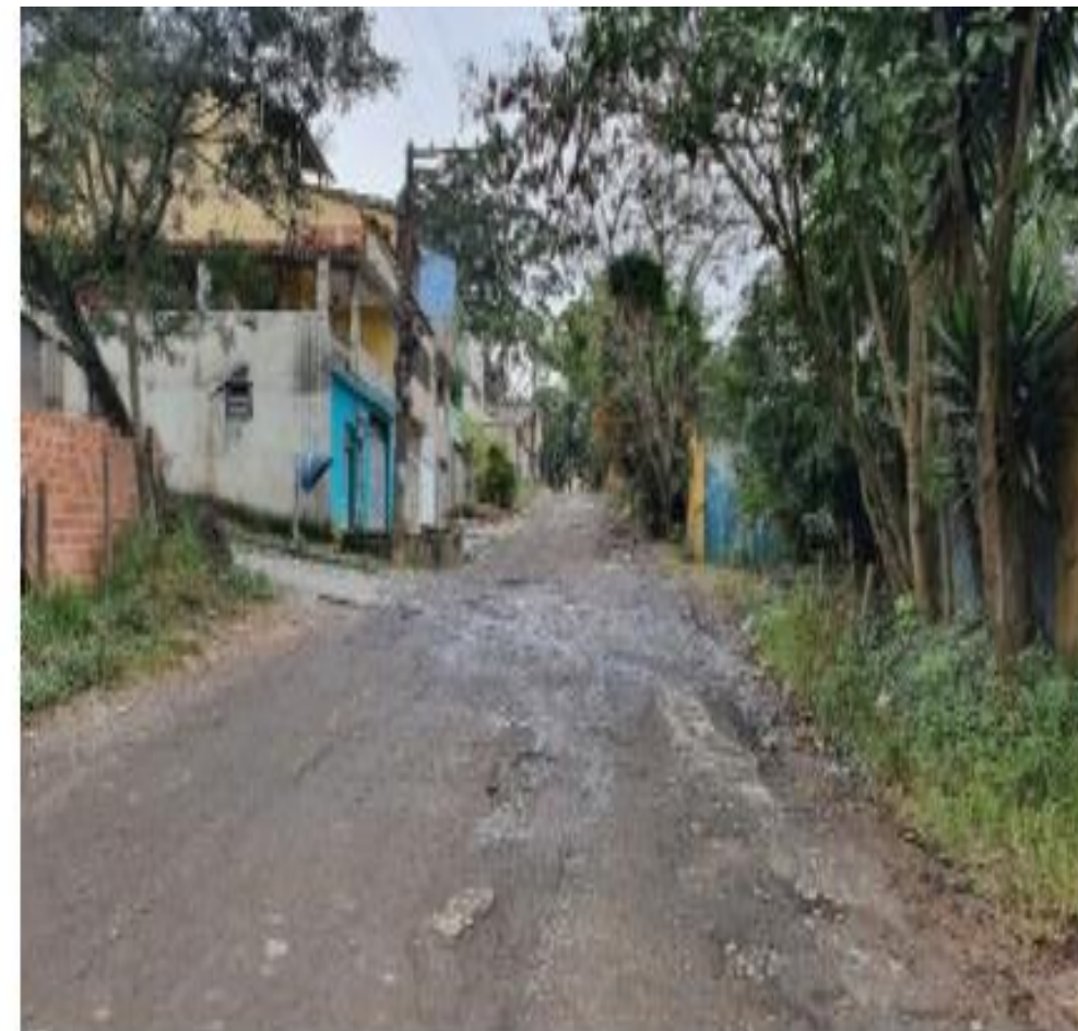
Rua Domingos da Guia com necessidade de drenagem pluvial.
