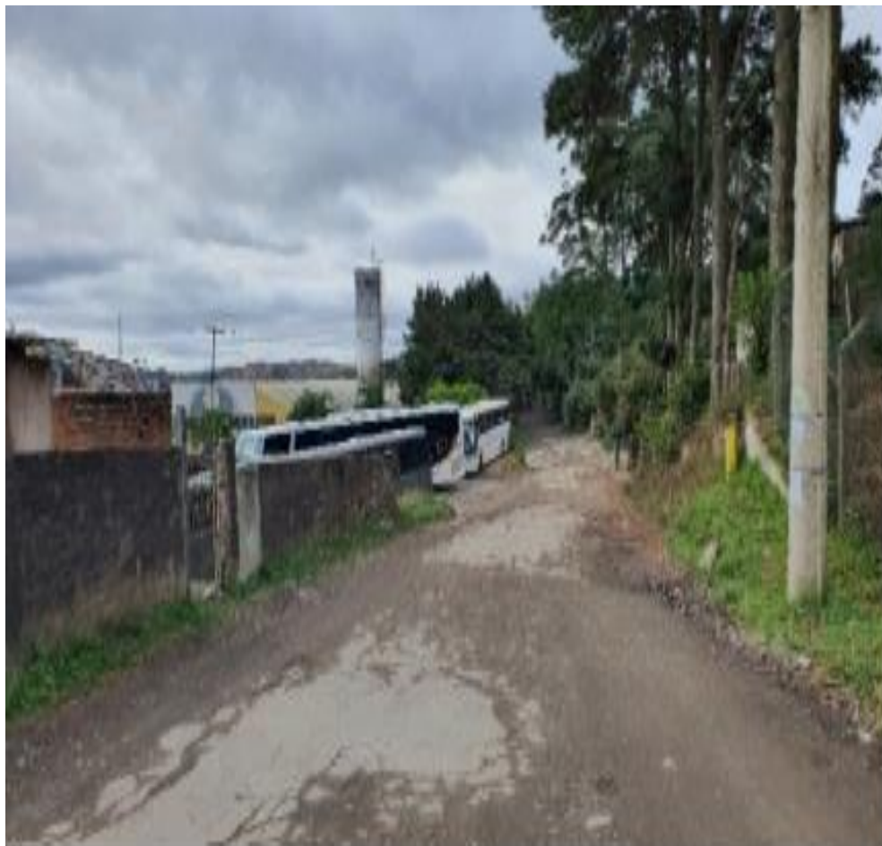
Rua Domingos da Guia com necessidade de pavimentação.
