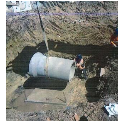
Assentamento do tubo de concreto na rede de drenagem da via - Foto: maio/24
