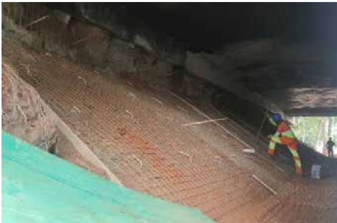
Obras de recuperação e reforço de Obras de Arte Especiais. Ponte Freguesia do Ó
