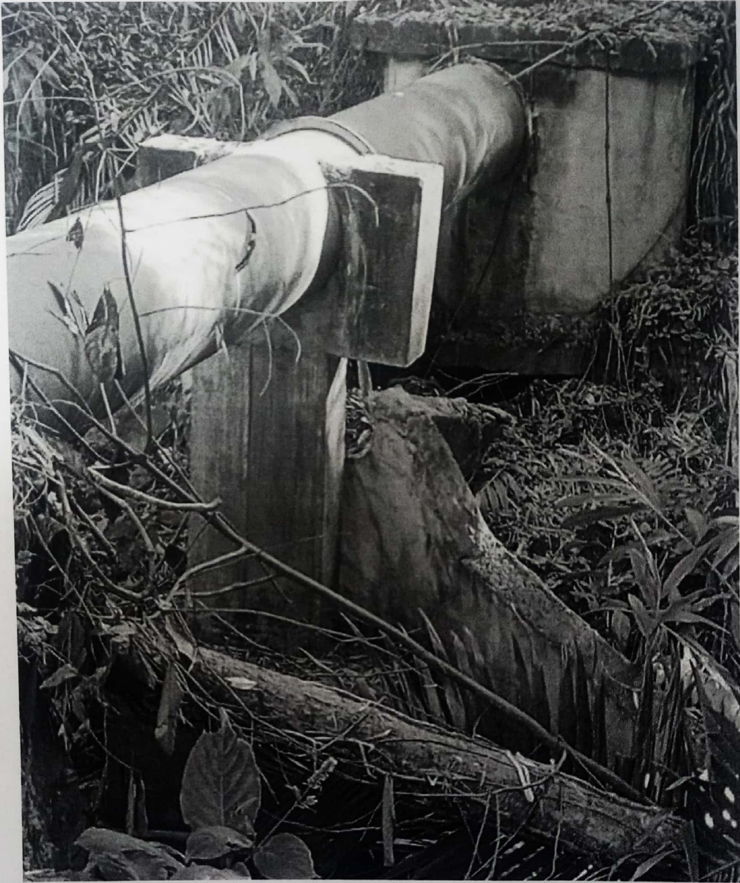
Foto 2: Antes da quebra do muro onde é possível ver o efeito cunha
