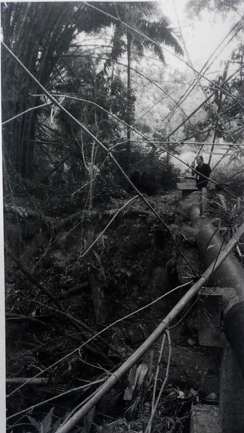
Foto 8: Erosão margem direita do córrego
