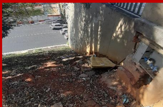
FIGURA 46: AMBIENTE DEGRADADO SOB O VIADUTO PEDROSO
