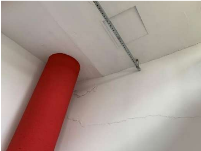
Pintura descascando e trinca na parede. Fonte: Foto do levantamento, 2024.
