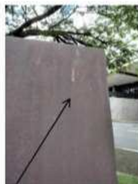
escorrido e manchas de ferrugem
