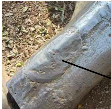
detalhe de antiga intervenção
