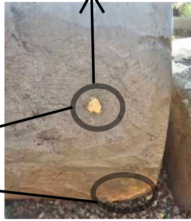
perda de suporte na base
