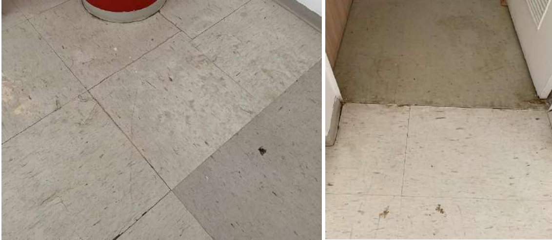
Piso com imperfeições. Fonte: Foto do levantamento, 2024.
