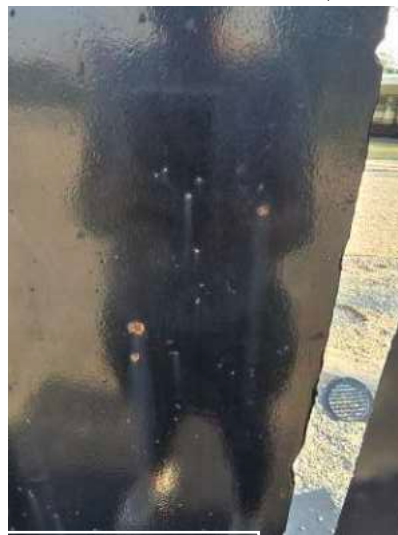
pontos de oxidação
