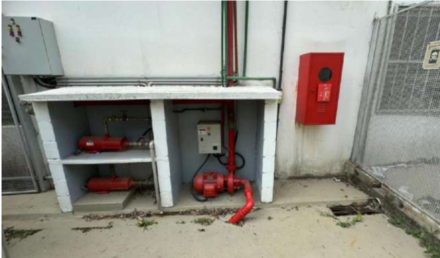
Bombas e reservatório inferior
