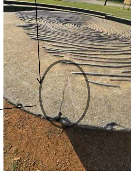
fissura e perda de material nas bordas
