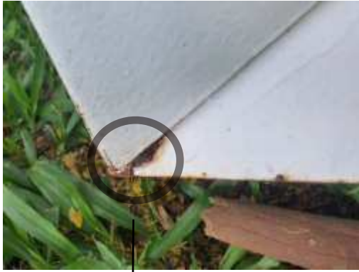
extremidades junto a base oxidadas
