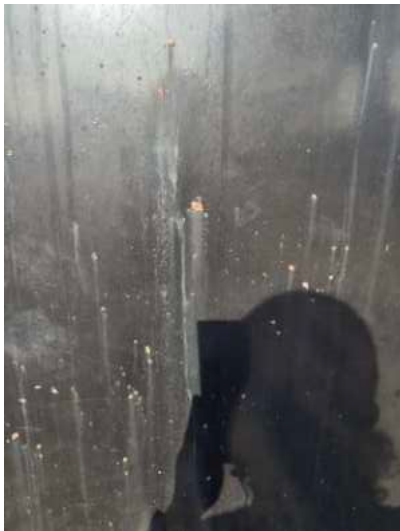
pontos de oxidação
