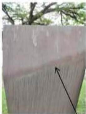
manchas esbranquiçadas e escorridos
