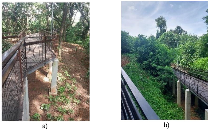
Figura 24 – Estrutura da passarela do parque e destaque para má execução do encontro entre o piso da passarela e os pilares de sustentação
