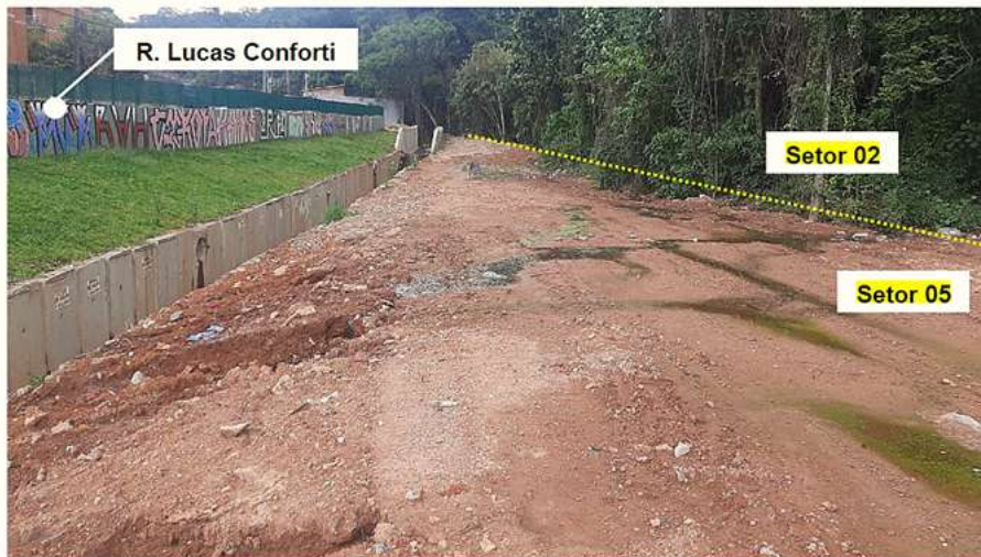
Figura 11 - Córrego a leste do parque. Notar a ausência de cobertura vegetal da margem do córrego recém canalizado, e os vazamentos de tubulação de águas servidas/esgotos provenientes das casas do entorno, e que atingem o córrego
