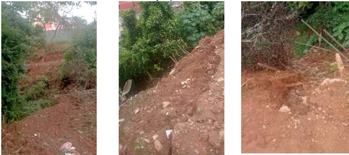
Figura 8 - Locais de alta declividade e solo exposto, com muito entulho e sujeitos à erosão e movimentos de massa, já apresentando sulcos e ravina
