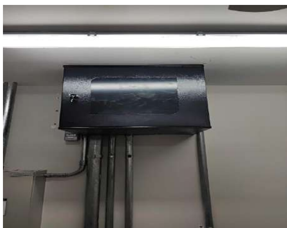
Figura 157 - RACK DE ARMAZENAMENTO DE SISTEMA INSTALADO
