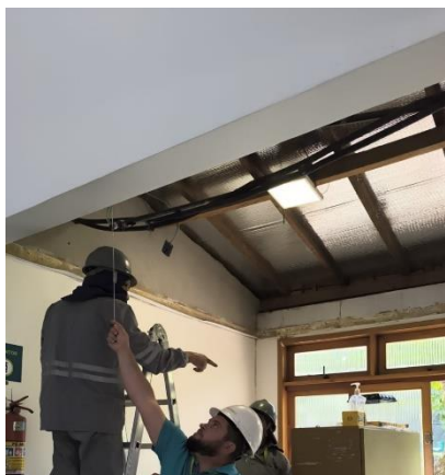
Figura 126 FORRO DA ADMINISTRAÇÃO
