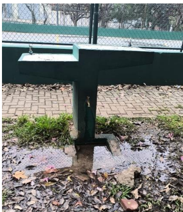
Figura 124 BEBEDOURO VAZANDO - ANTES
