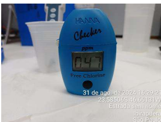
Figura 334: Medição diária de cloro na água da saída do tratamento - Poço artesiano
