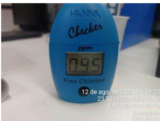
Figura300 : Medição diária de cloro na água da saída do tratamento - Poço artesiano
