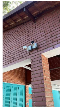
Figura 60 - INSTALAÇÃO DE CÂMERAS
