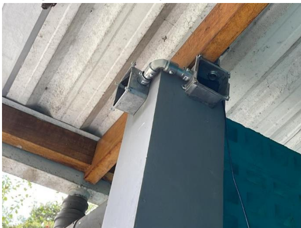
Figura 67 - INSTALAÇÃO DE CÂMERAS
