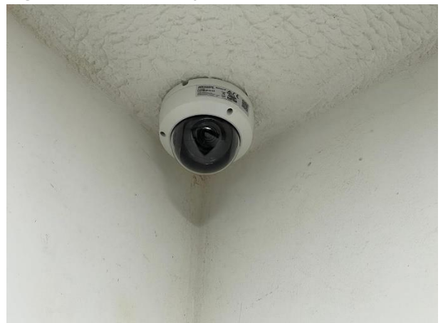
Figura 62 - INSTALAÇÃO DE CÂMERAS
