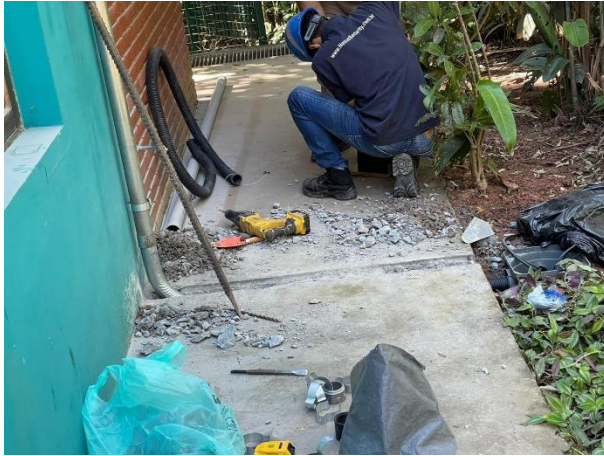
Figura 63 - INSTALAÇÃO DE CÂMERAS
