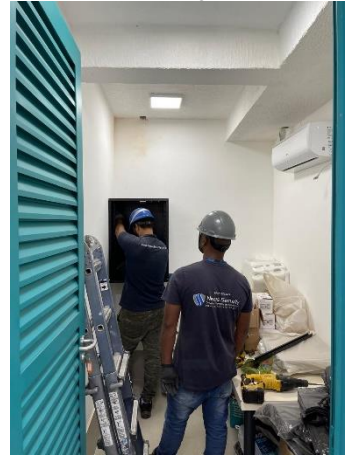
Figura 68 - INSTALAÇÃO DE CÂMERAS
