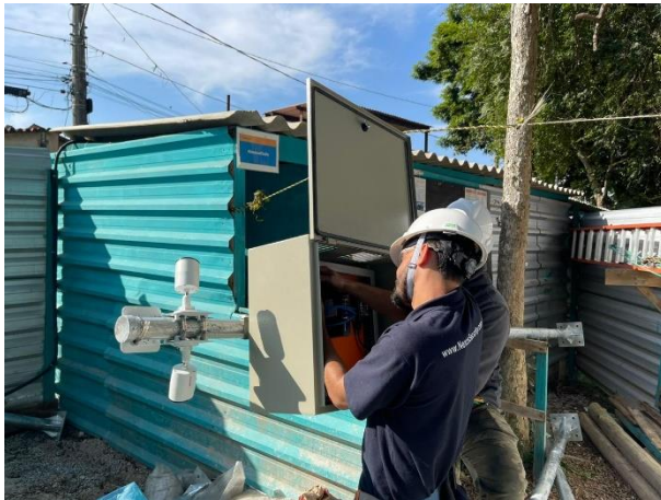
Figura 65 - INSTALAÇÃO DE CÂMERAS
