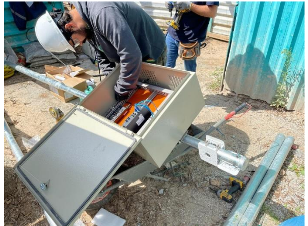
Figura 66 - INSTALAÇÃO DE CÂMERAS
