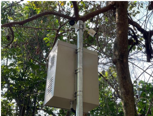
Figura 73 - INSTALAÇÃO DE CÂMERAS
