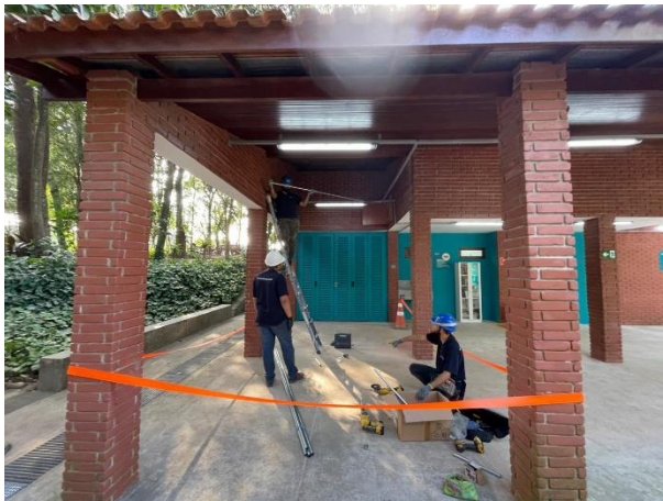
Figura 59 - INSTALAÇÃO DE CÂMERAS
