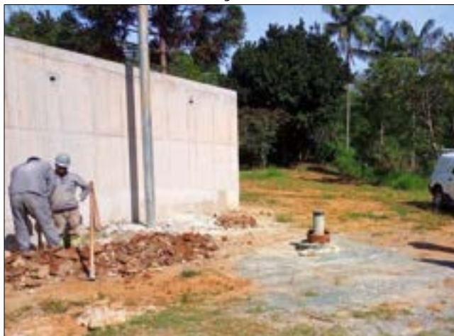
Figura II: 23 – Ausência de laje e cercamento para o Perímetro Imediato de Proteção Sanitária no Poço 2.
