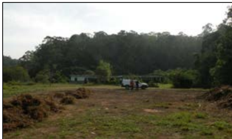
Figura II: 47 – Vista parcial do patamar obtido a partir do corte executado na encosta.
