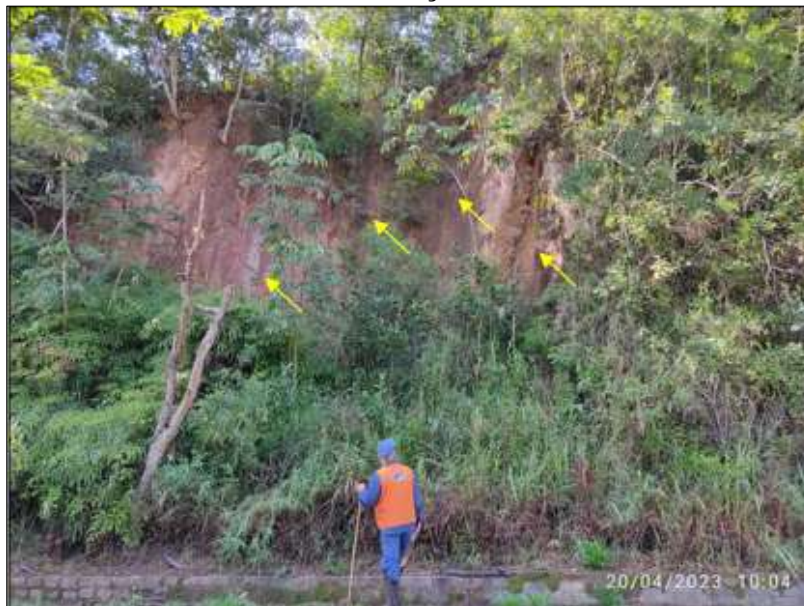
Figura II: 48 – Vista da principal ruptura observada no talude Assunção.
