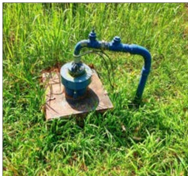
Figura II: 21 – Vista do Poço 1 - Poço tubular profundo.
