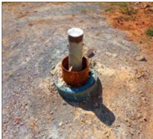
Figura II: 22 – Inconformidade construtiva do poço, com cimentação de um tambor de 200 litros de PVC azul.
